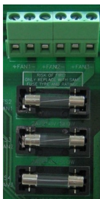
Figura 35 – Detalhe conector para grupos de ventiladores externos e proteções.
